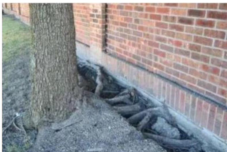
Slika 6. Pukotine zbog vegetacije [6]
