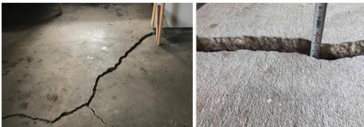
Slika 4. Pukotine u podnoj ploči [5]
