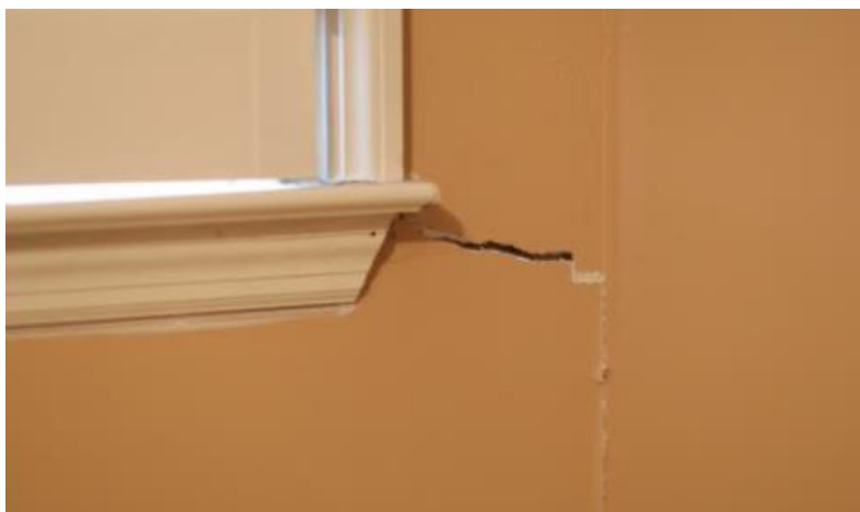
Slika 5. Pukotine u zidovima [6]
