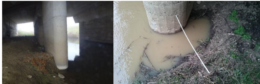
Slika 5. Erozija uslijed suženja toka u lijevom otvoru mosta (lijevo); pogled na kavernu uz uzvodno lice stupa S1/1
