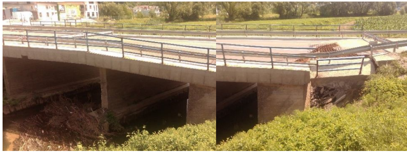
Slika 10. Most Đurmanec: a) nagomilani plutajući nanos u središnjem otvoru mosta (lijevo); b) erozija obale iza upornjaka (desno) / Autor: M. Skazić
