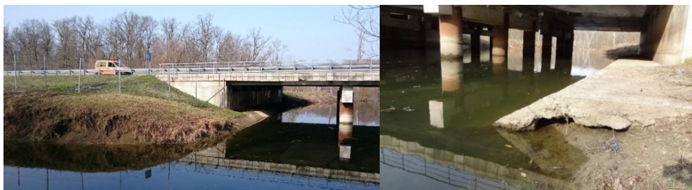
Slika 3. Urušavanje obale na ušću sabirnog kanala (lijevo); detalj podlokane betonske obloge desne obale (desno).
