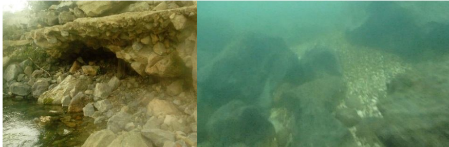
Slika 7. Detalj urušene zaštite od kamenog nabačaja stupova S15: a) na sjevernom pokosu (lijevo); na južnom pokosu (desno)
