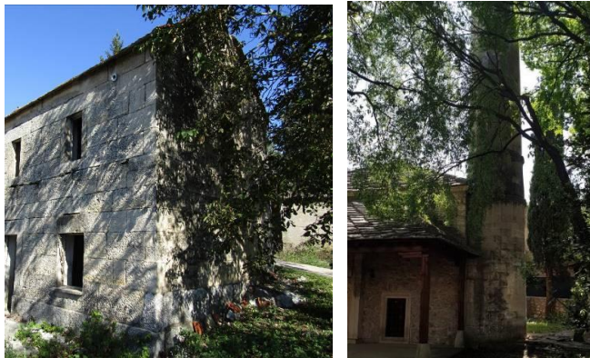
Slike 13.-14. Primjeri utjecaja okolnog raslinja: kuća u Tomića Brigu-Vinjani kod Posušja, s utjecajem obližnjeg drveta oraha na istočnoj strani objekta, čije listove ispire kiša i stvara određeno zakiseljenje kišnice (lijevo); Minaret džamije kod Pješačkog mosta Bunur u Mostaru sa jače izraženom patiniranošću kamena zbog blizine okolnog raslinja i r. Neretve (desno), (foto: K. Šaravanja), [6]
