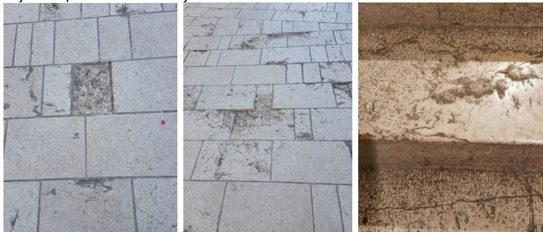
Slike 10.-12: Neujednačenost prslina i oštećenja u opterećenoj pješačkoj zoni starog grada Sarajeva (lijevo i sredina), kao i izvornih unutarnjih stepenica u prostoru Umjetničke galerije BiH u Sarajevu 10
